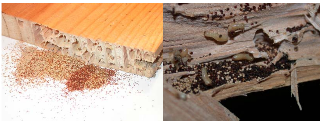
Figura 4. Aspecto de uma grande infestação provocada pela Cryptotermes brevis . a) corte de uma tábua de forro; b) viga destruída.
