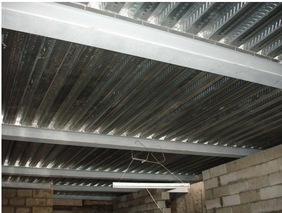
Figura 5. Exemplo de uma estrutura metálica recentemente instalada num edifício de Angra do Heroísmo.
