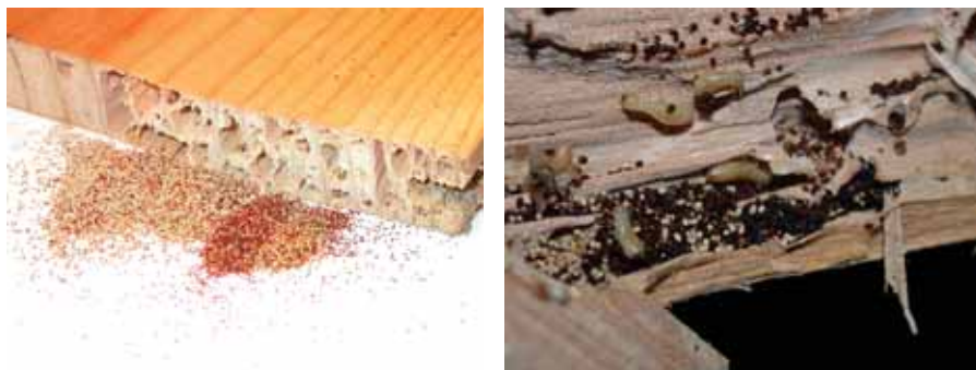
Figura 4 – Aspecto de uma grande infestação provocada por Cryptotermes brevis . a) corte de uma tábuia de forro; b) viga destruída.
